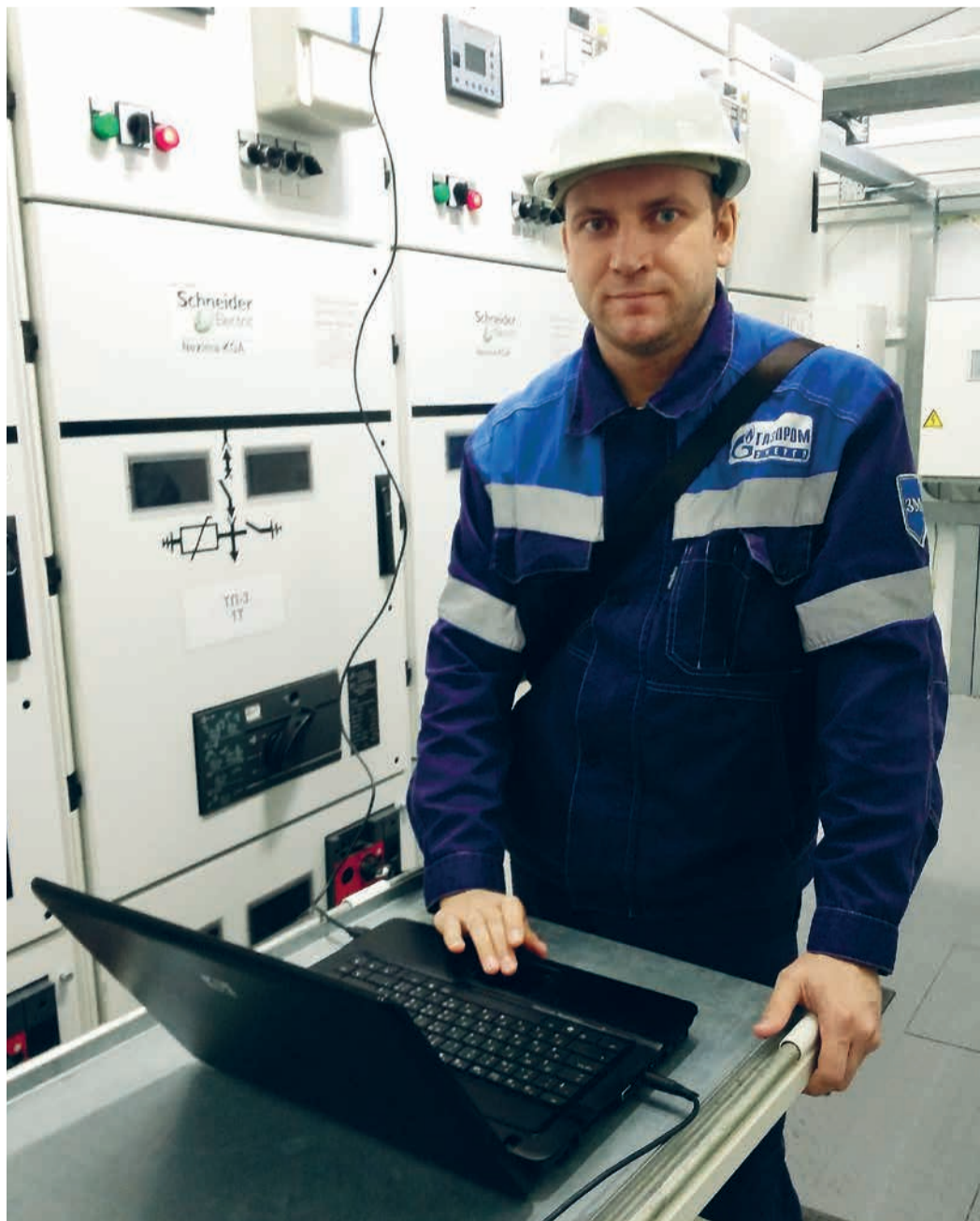
Настройка счетчика электроэнергии в составе АСКУЭ
