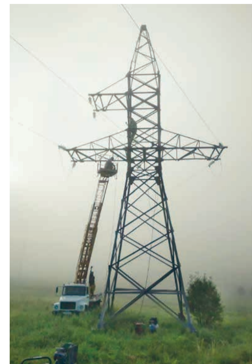
ВЛ-35 кВ КС «Писаревка»
