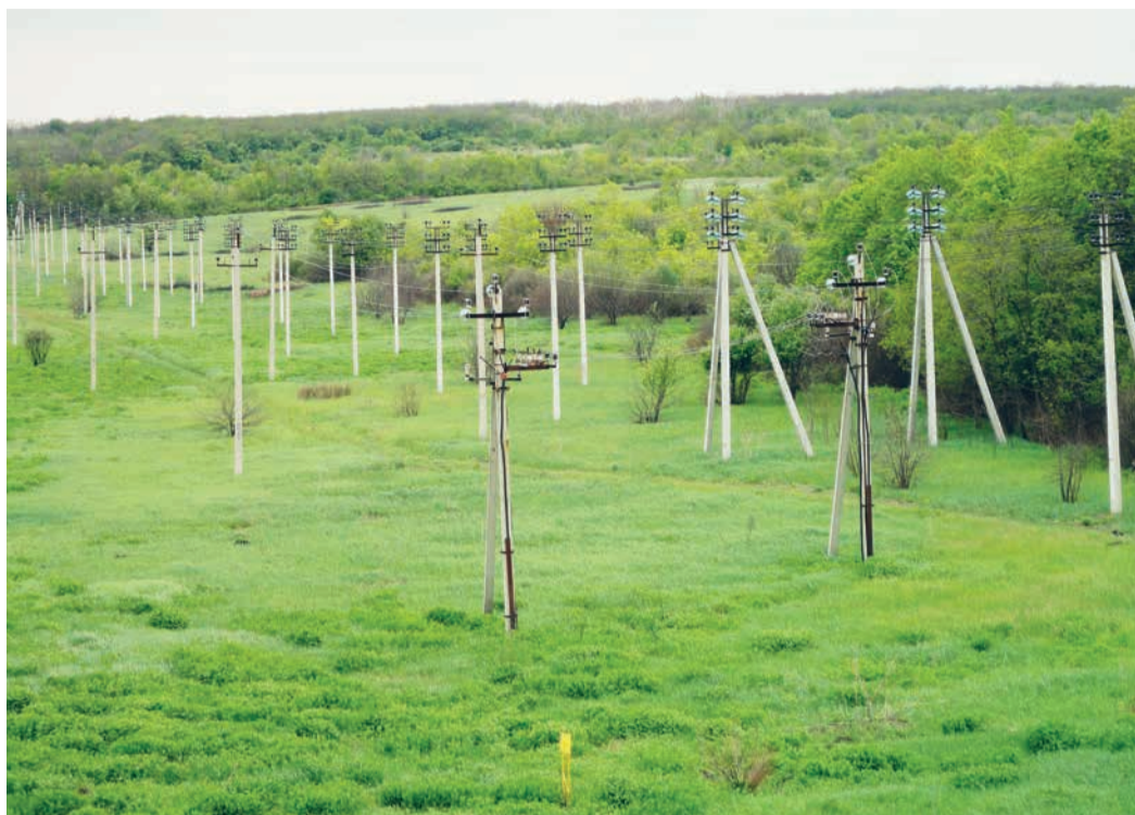
Вдольтрассовая ВЛ-10 кВ газопровода КС «Сохрановка» – КС «Октябрьская»
