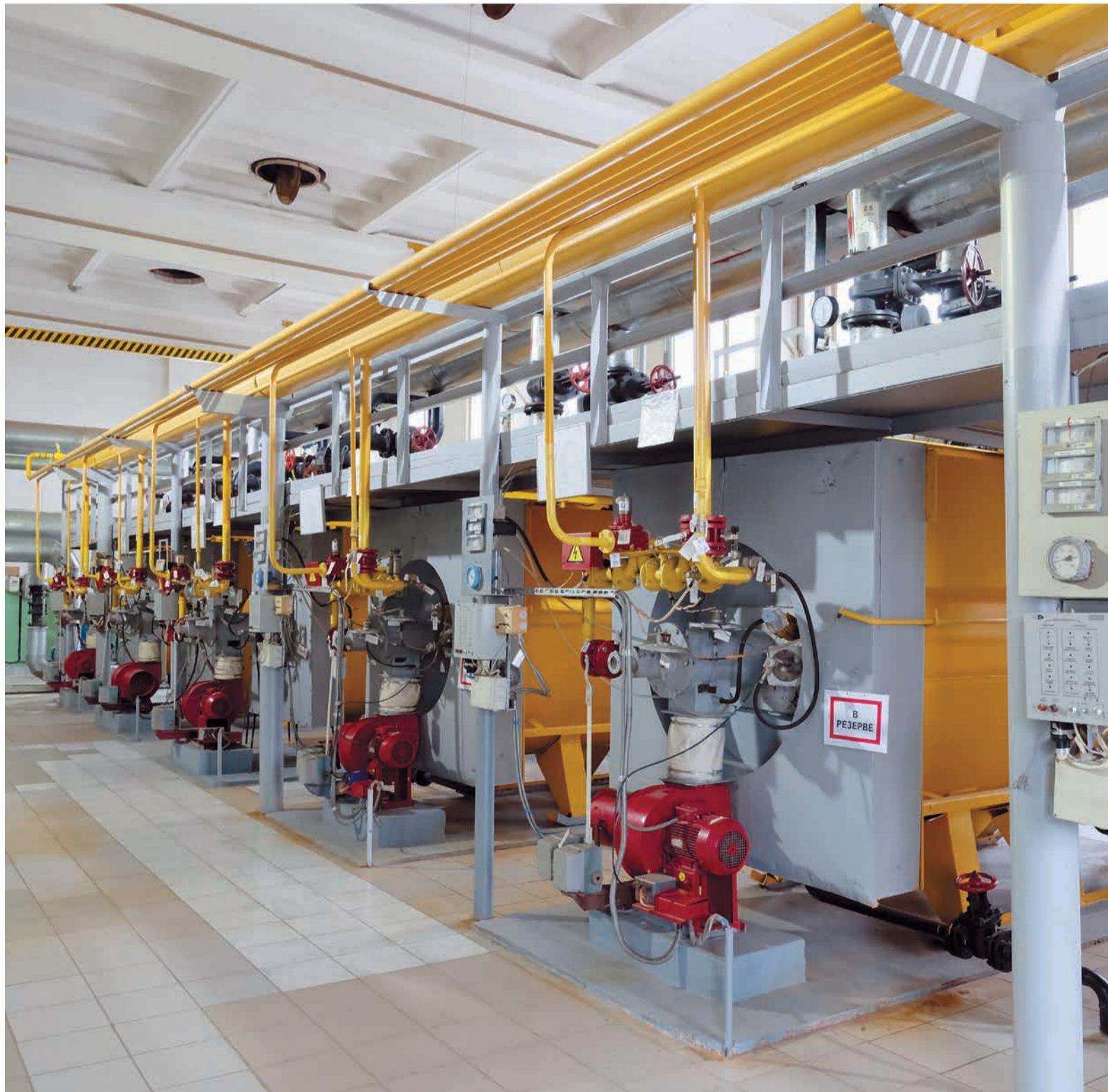
Котельная в поселке Коммунарка (Москва) – один из объектов, перешедших в собственность «Газпром энерго»
