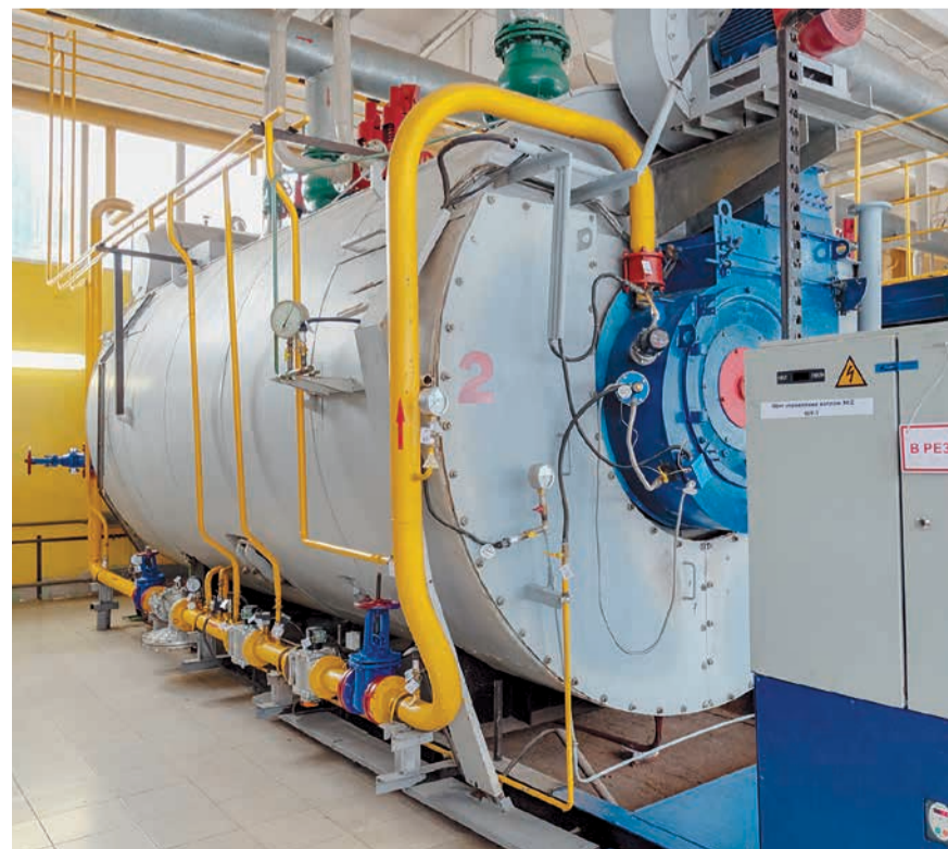
Котельная поселка Газопровод
