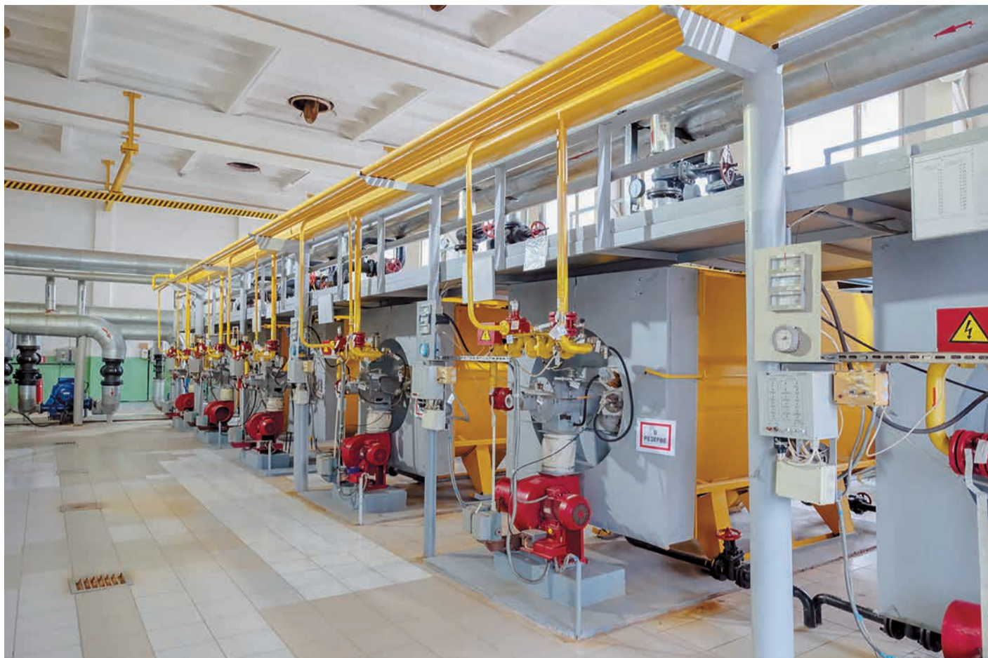
Машинный зал котельной ПСБ «Коммунарка»
