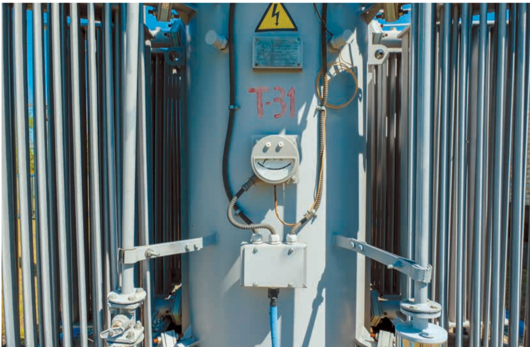
Улыбочку. Подстанция «Рождественская», поселок Рыздвяный Ставропольского края
