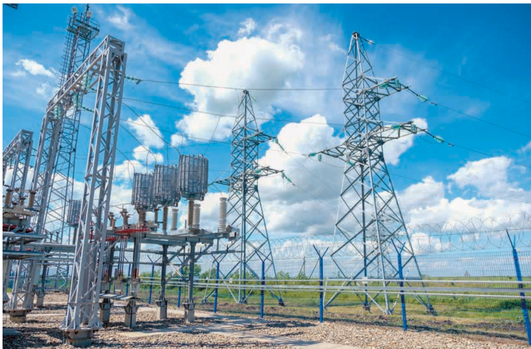
Подстанция «Компрессорная», Майкоп, Республика Адыгее
