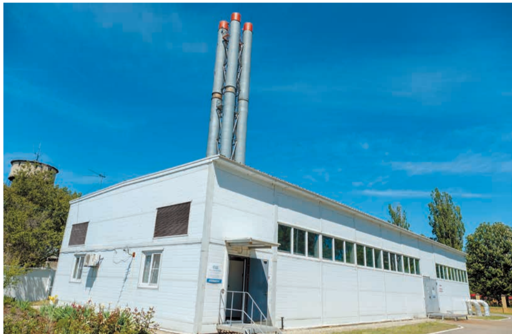
Котельная №1 в поселке Рыздвяном Ставропольского края
