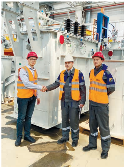
На испытательной станции завода
