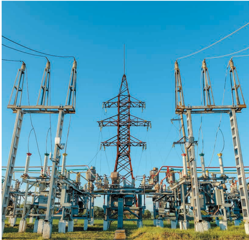
Подстанция «Газовая», Успенский район Краснодарского края
