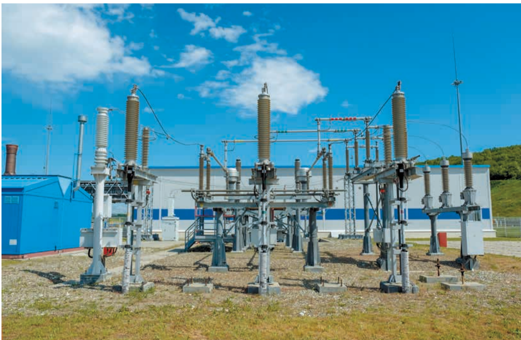
Подстанция «Русская», Анапа, Краснодарский край
