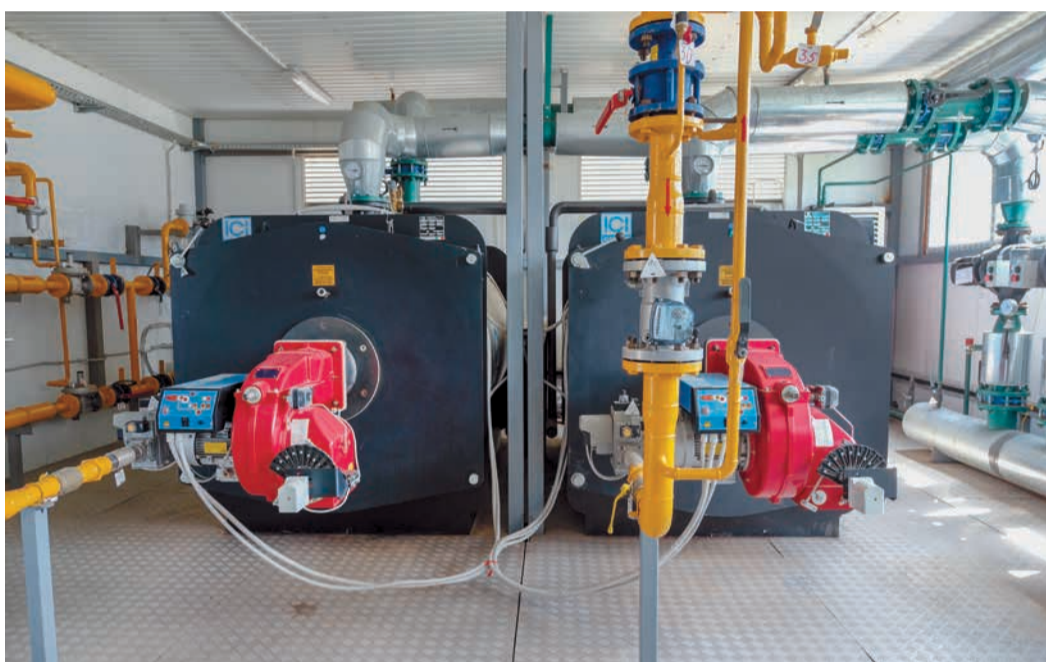
Оборудование котельной в станции Каневской, Краснодарский край
