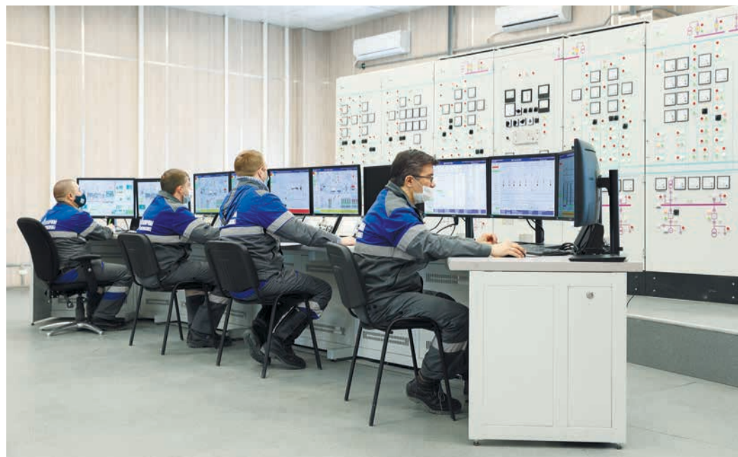
Щит управления электростанции собственных нужд. Фото Егора Стыценко, «Газпром добыча Ноябрьск»
