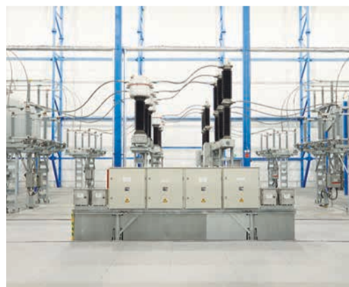
ЗРУ 110 кВ. Фото Егора Стыценко, «Газпром добыча Ноябрьск»
