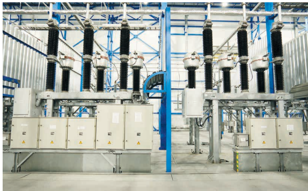
ЗРУ 110 кВ. Фото Егора Стыценко, «Газпром добыча Ноябрьск»
