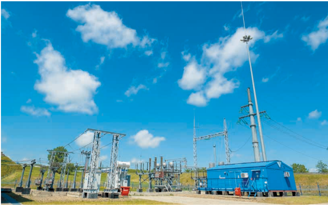
Подстанция «Казачья» неподалеку от Славянска-на Кубани, Краснодарский край
