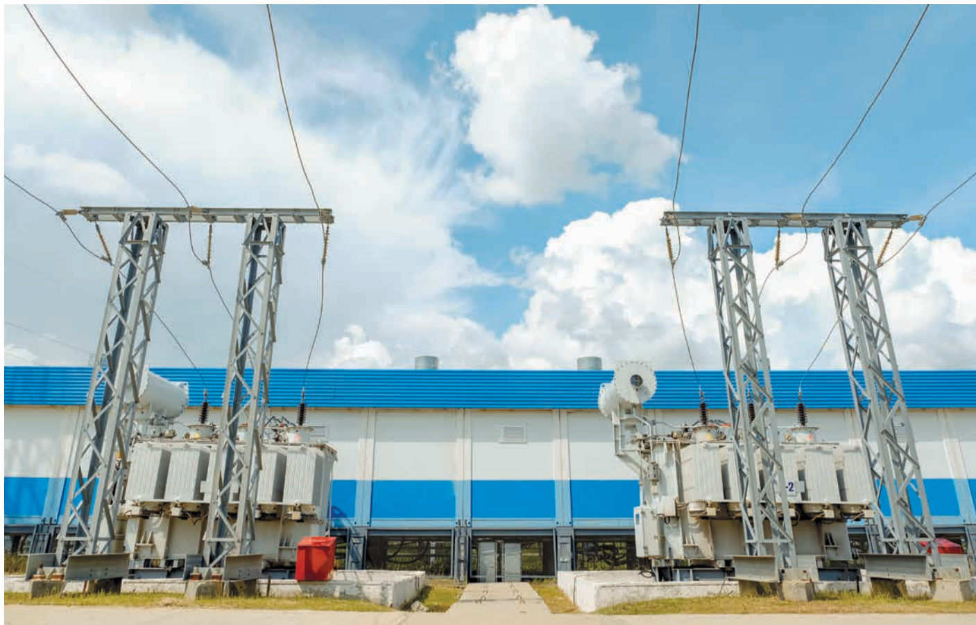
ПС 35/10 кВ «Латухино-2», ОРУ-35 кВ
