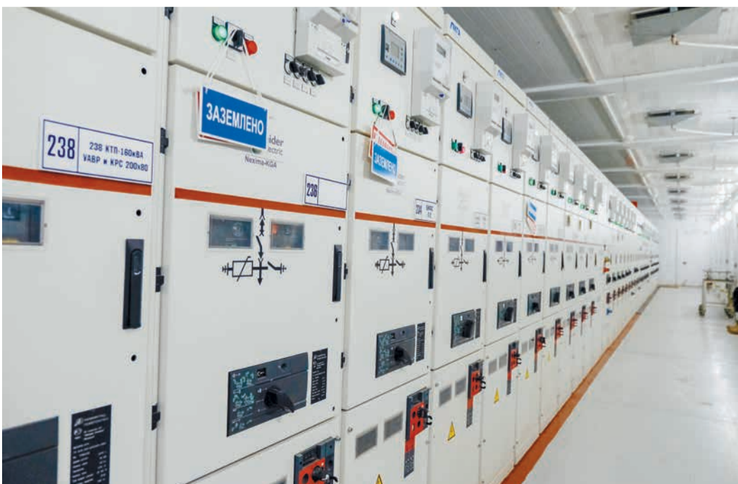
ПС 35/10 кВ «Латухино-2», ЗРУ-10 кВ
