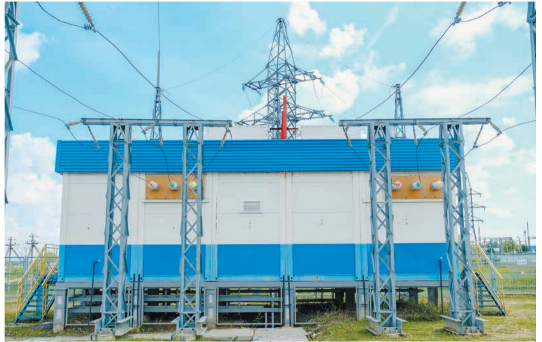
ПС 35/10 кВ «Латухино-2» ЗРУ-35 кВ
