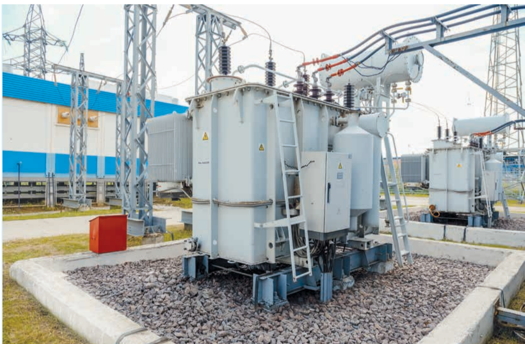
ПС 35/10 кВ «Латухино-2», трансформатор ЗРУ-35 кВ 10 МВ·А
