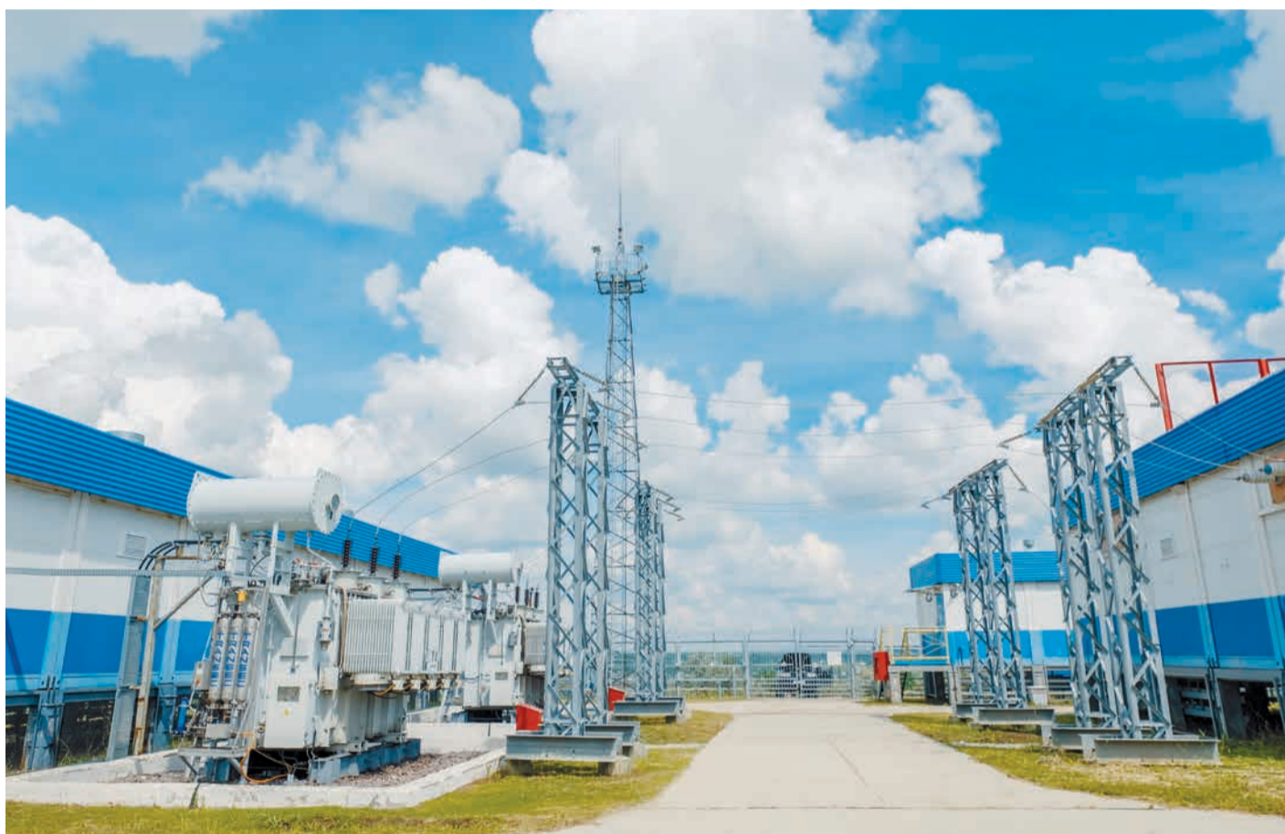
ПС 35/10 кВ «Латухино-2», ОРУ-35 кВ
