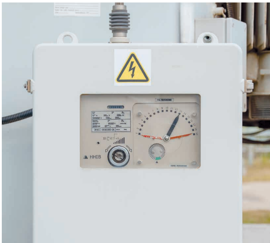
Устройство регулирования напряжения трансформатора под нагрузкой, ПС 35/10 кВ «Латухино-2»
