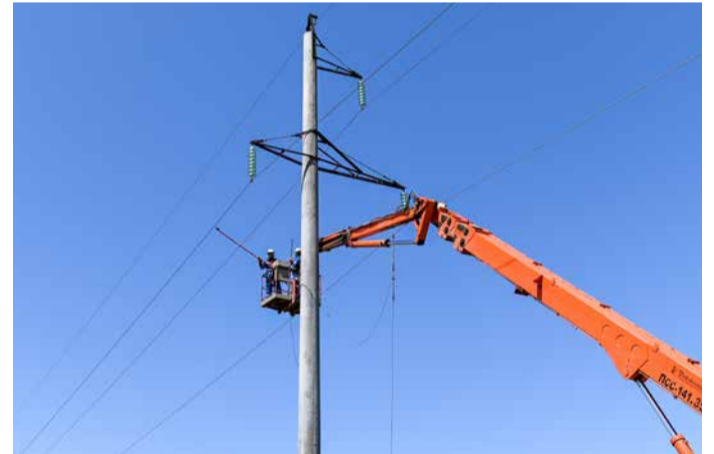
Проверка отсутствия напряжения. Установка переносного заземления
