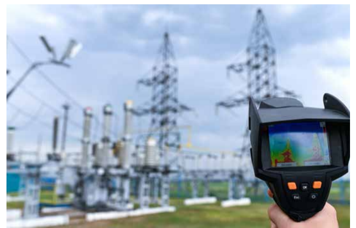
Фотофиксация контактных соединений
