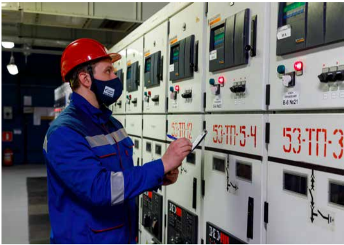
Дежурный электромонтер на смене
