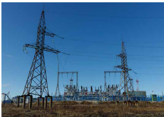
Воздушные линии 110 кВ
