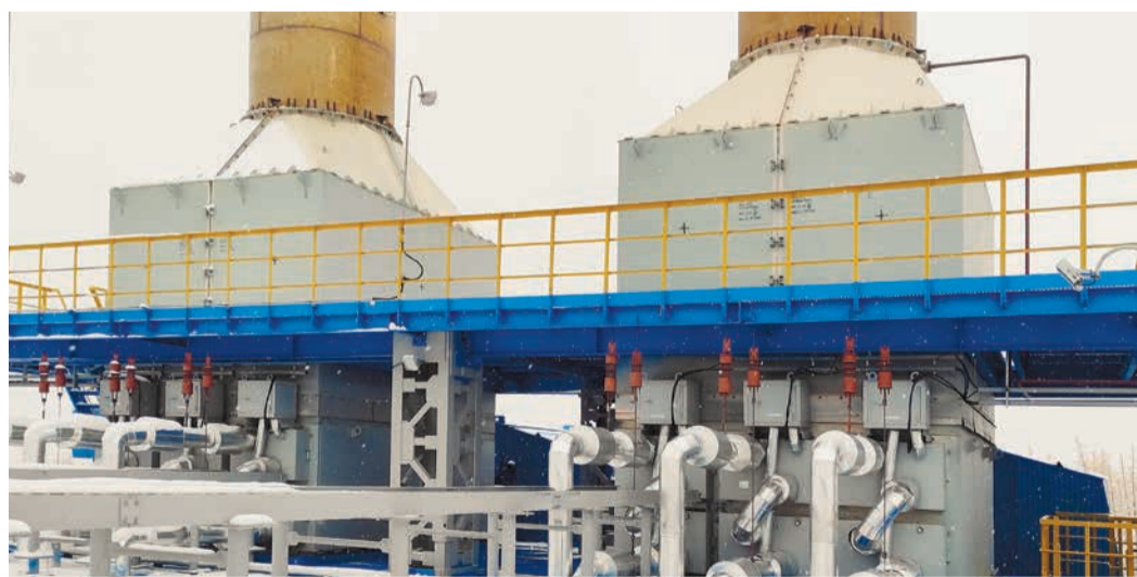
Утилизационные теплообменники (УТО)
