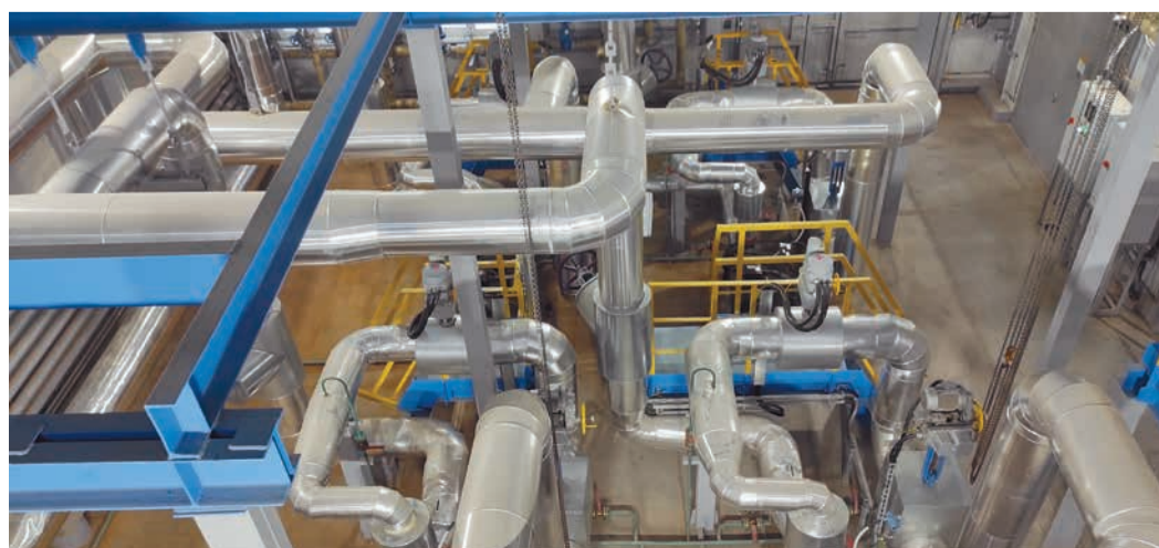
Тепломеханический блок ЭСН
