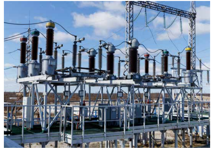
Подстанция ПС 110/6 ЗС
