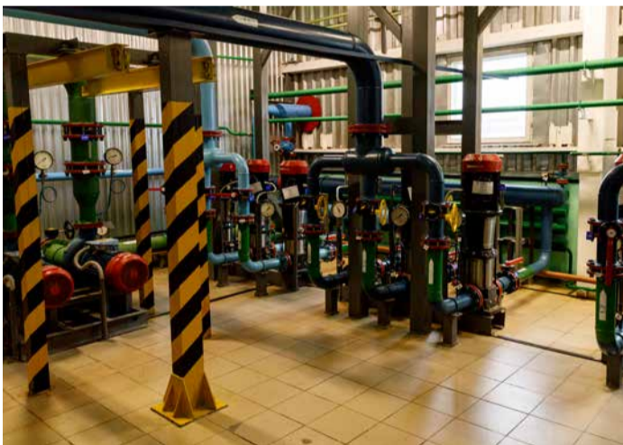
Водоочистная станция (ВОС)
