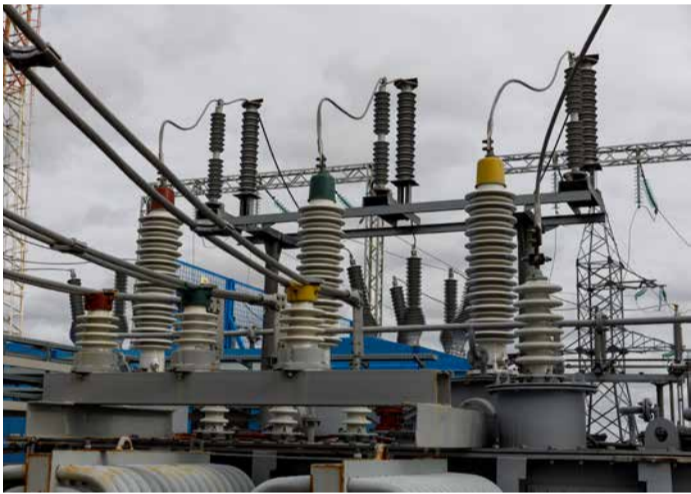
Подстанция ПС 110 кВ ГКС
