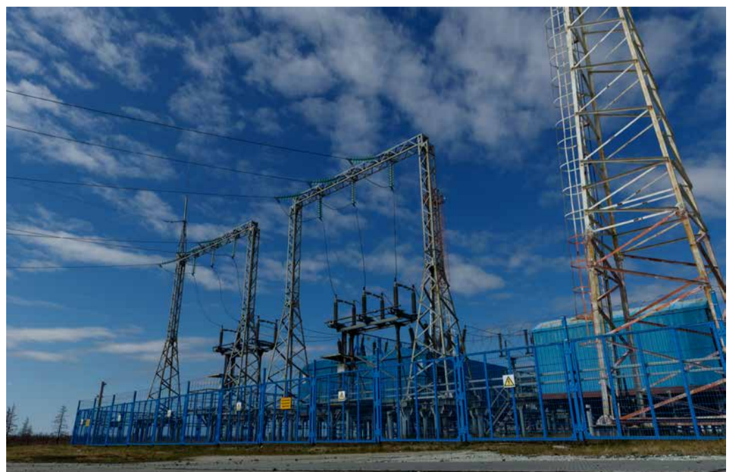
Подстанция ПС 110 кВ ГКС
