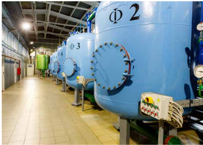
Зал фильтров водоочистной станции
