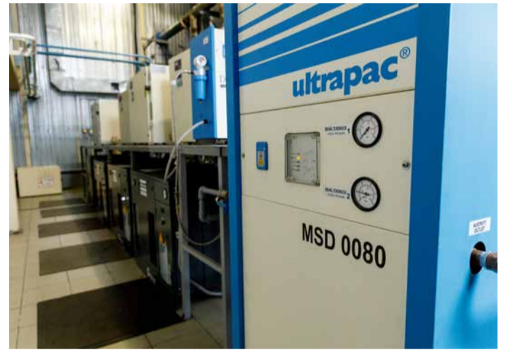
Озоногенераторы водоочистной станции
