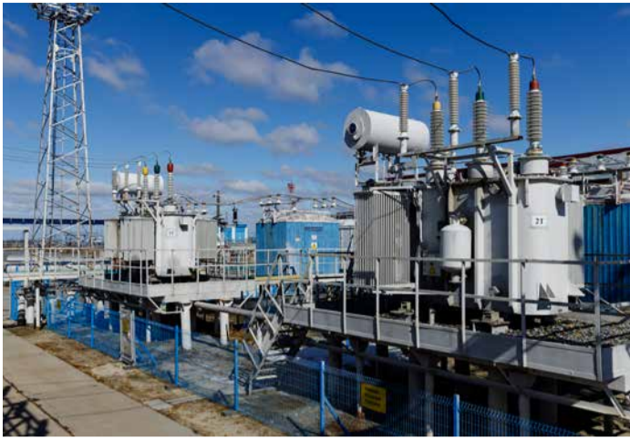
Подстанция ПС 110/6 ЗС. Заполняющее управление ЭВС
