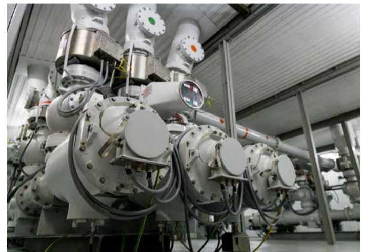
Элегазовый выключатель 110 кВ
