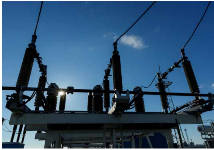
Подстанция ПС 110/6 ЗС. Заполняющее управление ЭВС
