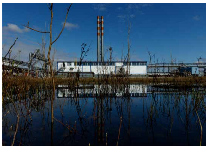
Котельная № 1. Заполярное управление ЭВС
