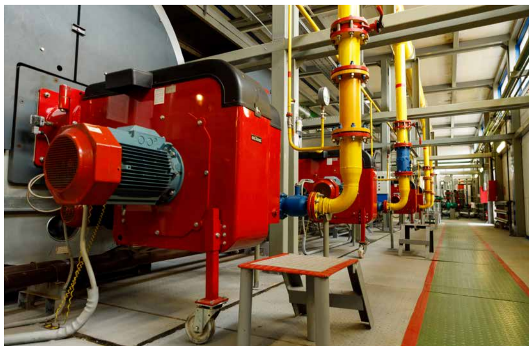
Фронт котлов котельной № 1
