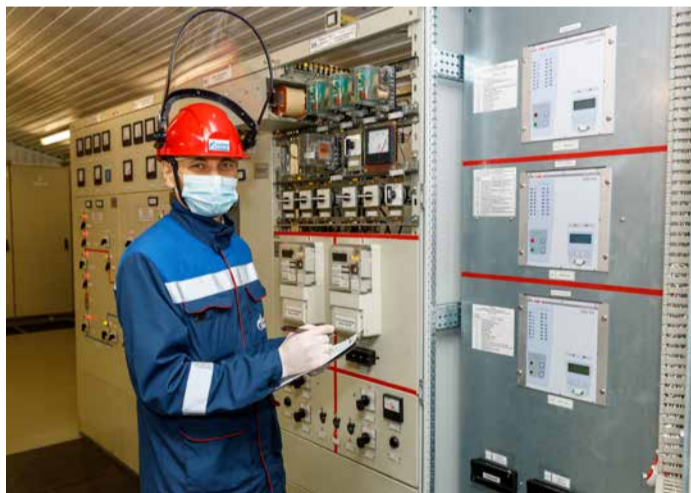
Дежурный электромонтер на смене. Подстанция ПС 110 кВ ГКС
