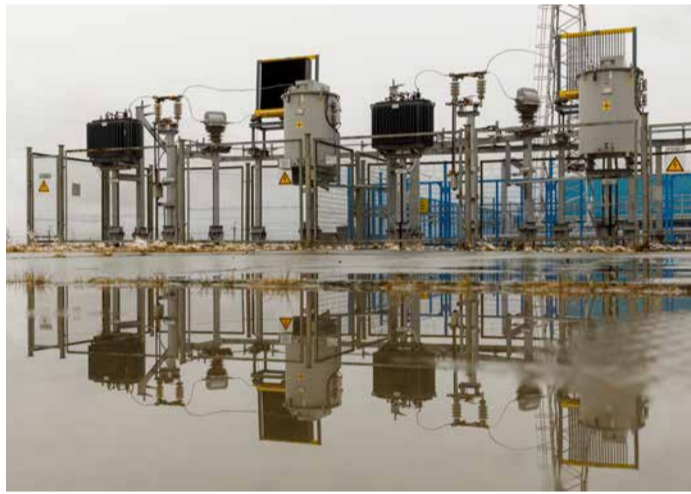
Подстанция ПС 110/6 ЗС
