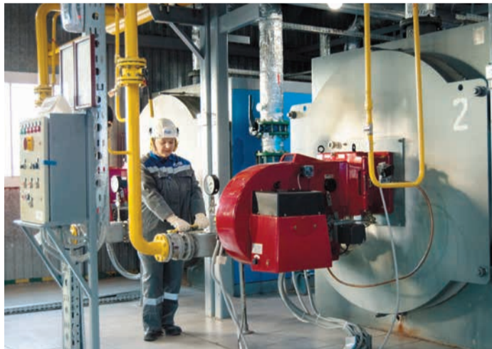
Оператор котельной п. Заполярный Пушкарёва Е.Д.
