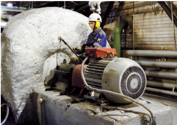
Дымосос, котельная ДКВР. Слесарь-ремонтник Мартыничук С.В.
