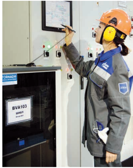
Котельная 72 МВт. Аппаратчик химводоочистки Присяжная Н.В.
