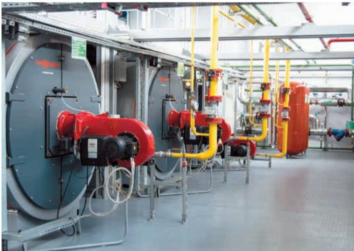
Котельная Ныдинского водозабора
