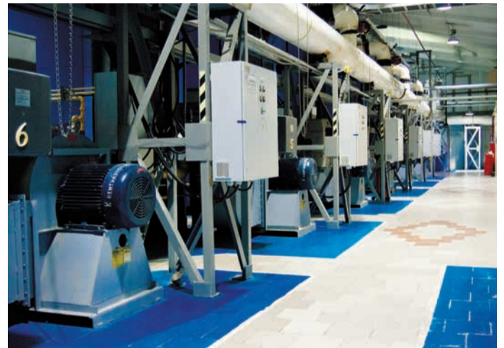
Производственный цех котельной 72 МВт п. Пангоды
