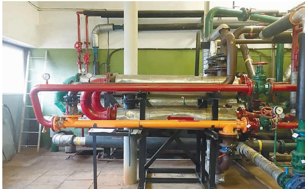
ЦТП-3 п. Газопровод
