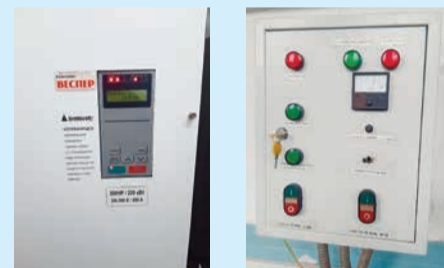
Шкафы управления ЧРП
