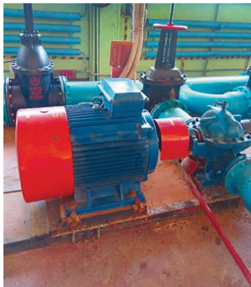
Насосный агрегат № 5 водопроводных очистных сооружений ВОС -1
