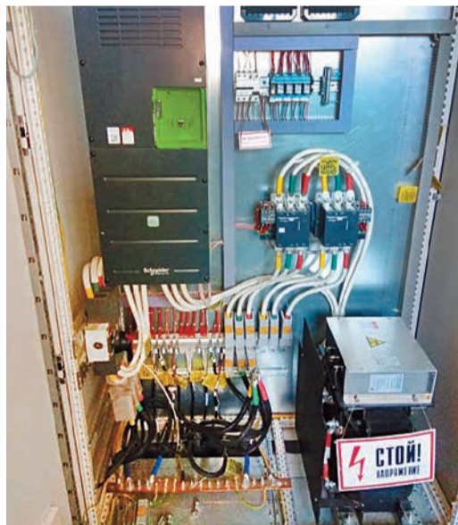
Шкаф управления ЧРП водопроводных очистных сооружений ВОС -1
