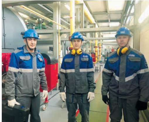
Работники Участка газового хозяйства (на фото слева направо) Зуфар Халиков, Игорь Гертум, Роман Ковальчик выполняют осмотр технического состояния газорегуляторных установок согласно графика планово-предупредительного ремонта газового оборудования, арматуры
