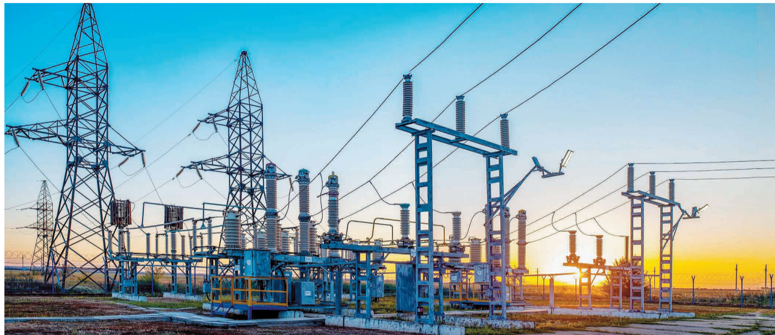
Объект Южно-Уральского филиала ООО «Газпром энерго» (фото Артёма Ерёмкина)
