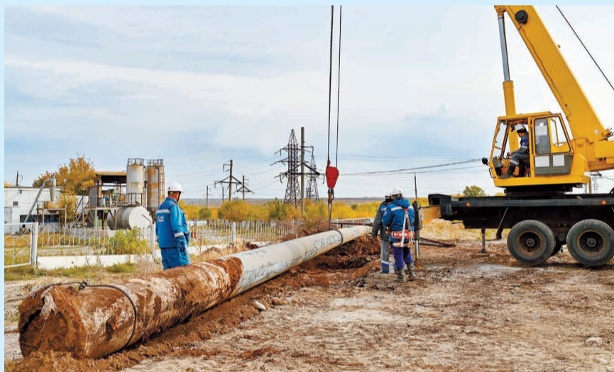
Демонтированная железобетонная опора
