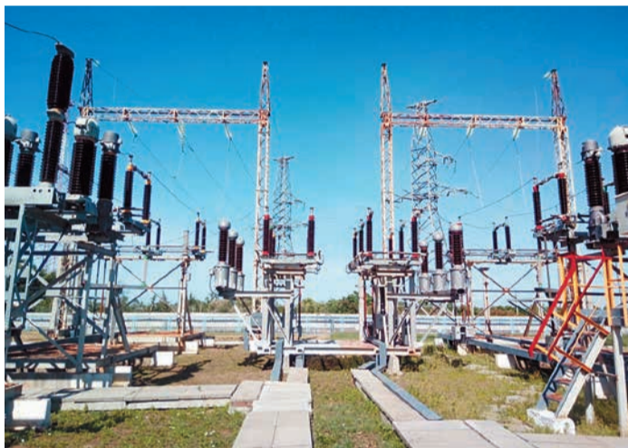
Трансформаторная подстанция КТПБ-110/10 кВ с двумя ТМН-6300 кВА КС-07 «Волгоградская»
