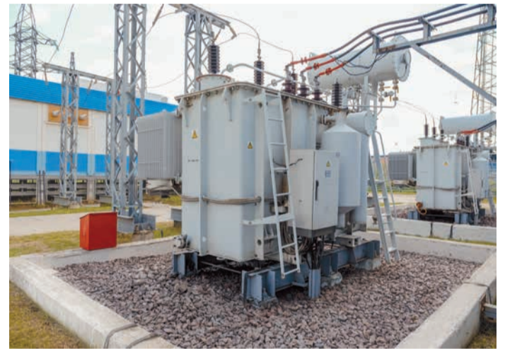
ПС 35/10 кВ «Латухино-2», трансформатор ЗРУ-35 кВ 10 МВА
