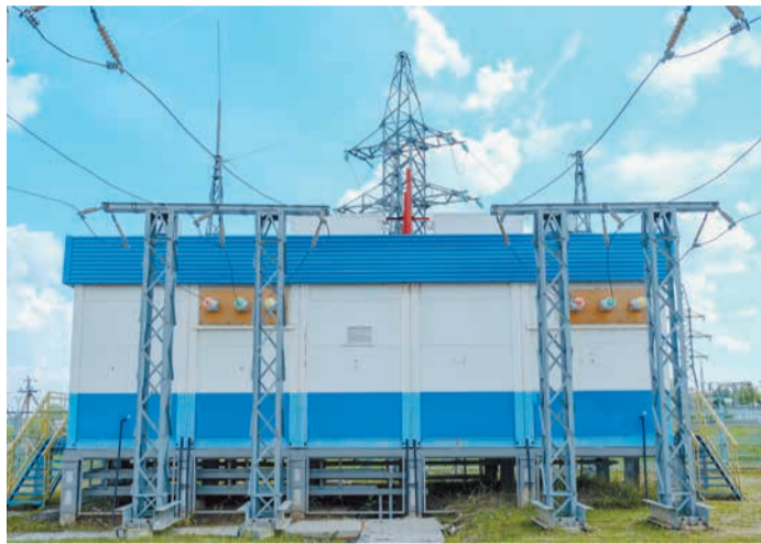
ПС 35/10 кВ «Латухино-2» ЗРУ-35 кВ
