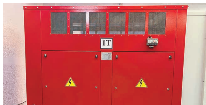
Новый сухой трёхфазный трансформатор
