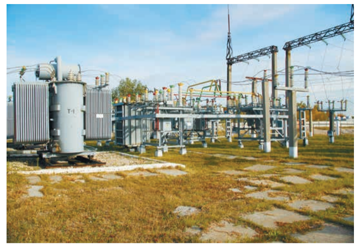
Объект ПС 35/10 кВ КС «Сызранская»
