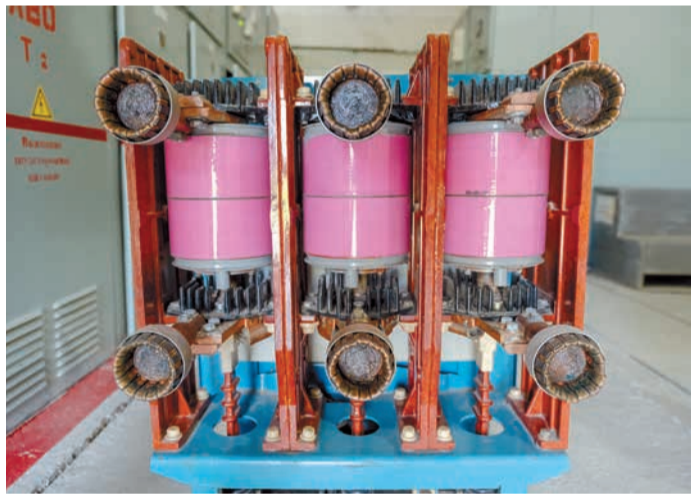
Высоковольтный выключатель ЗРУ-10 кВ «Песчаный Умёт»
