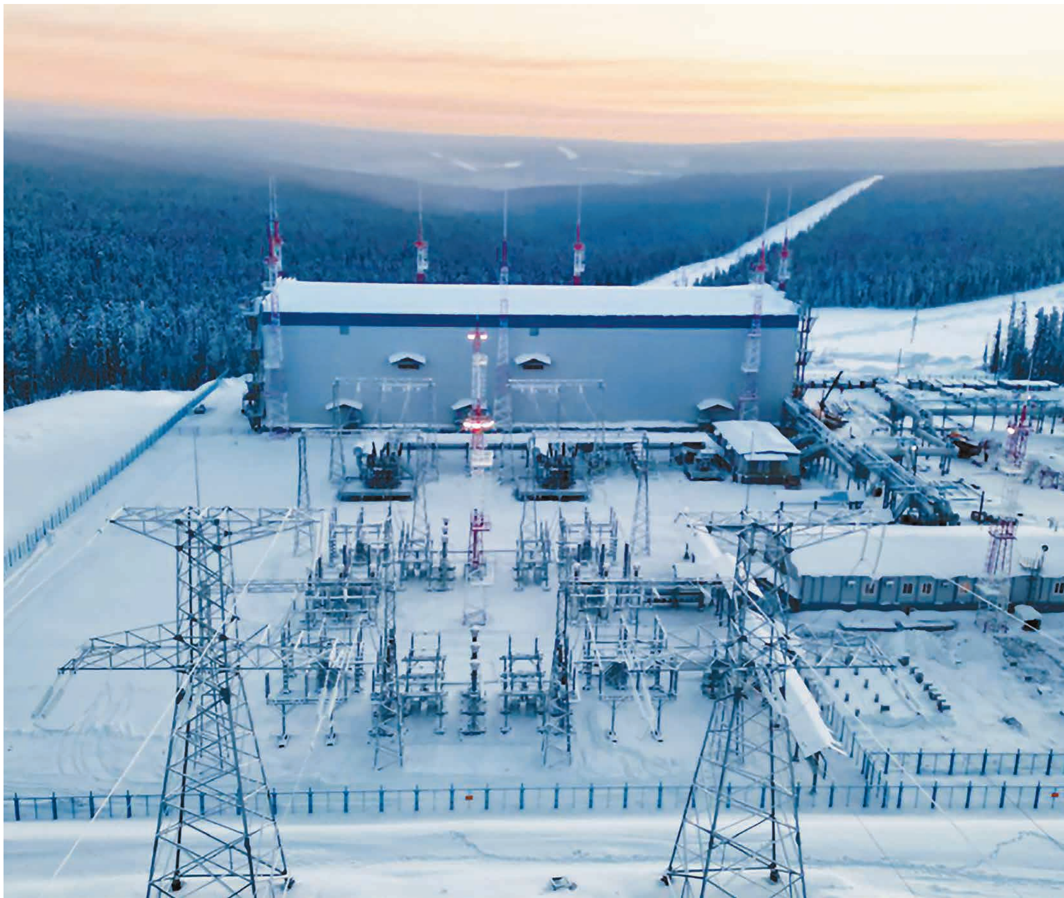
В юбилейный для компании год на подстанцию 220 кВ «Ковыкта» Иркутского филиала подали напряжение
