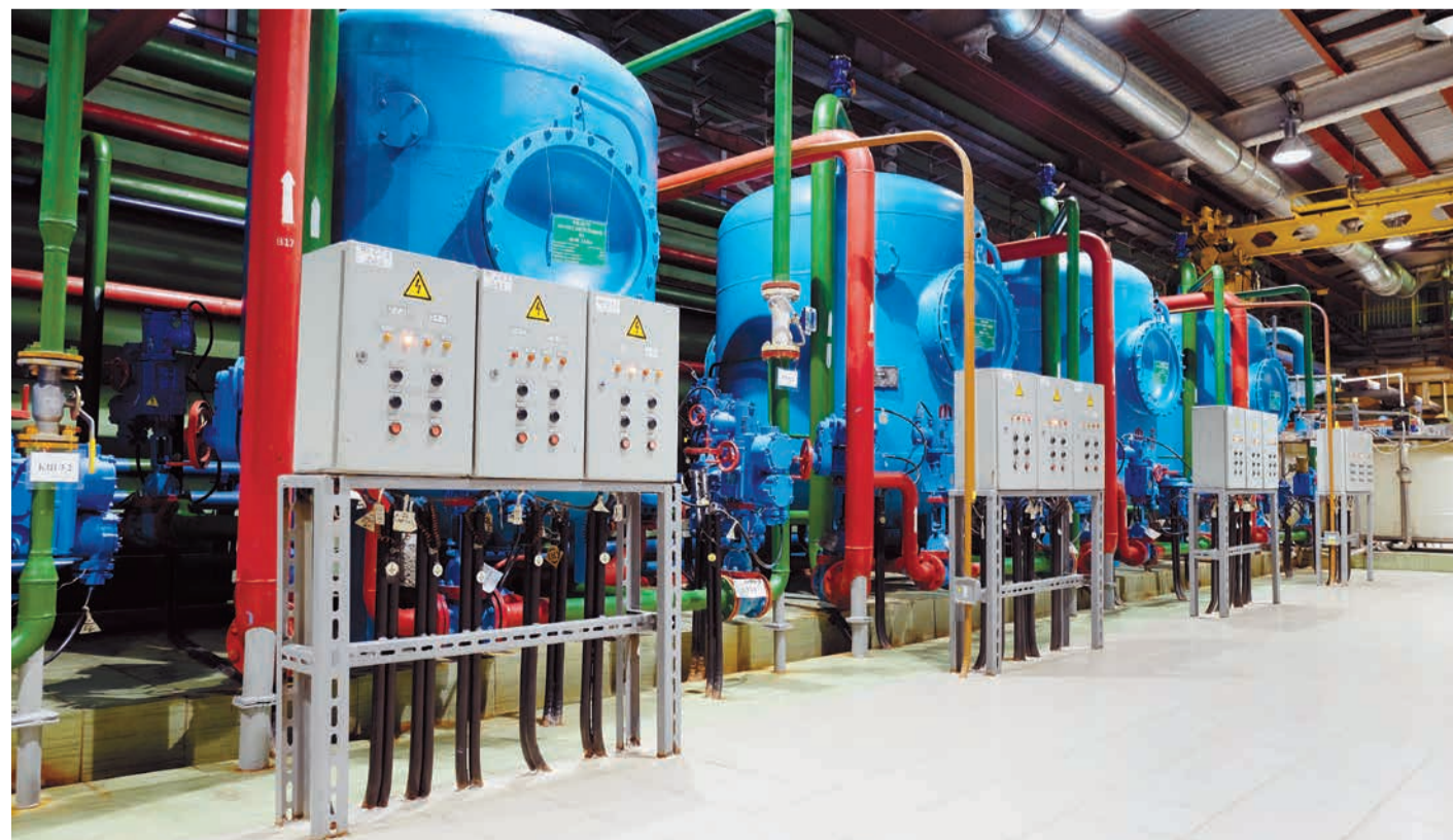
Станция обезжелезивания воды
